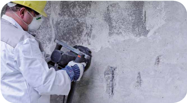
Puhasta kahjustunud betoonpind ning välja tulnud armatuur.
